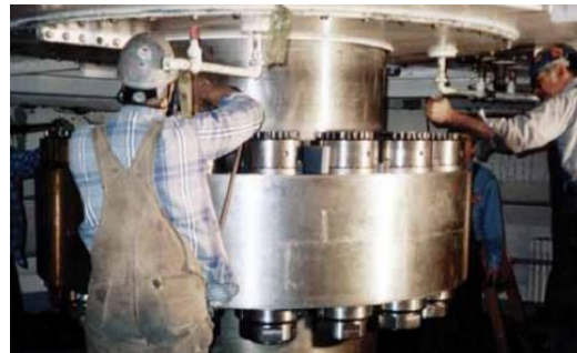
Acople de un eje de turbina con Super-Bolt, tensionado con llave de torque manual
